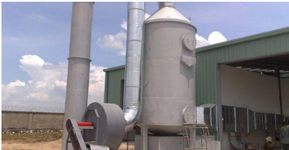
Hình 3.4. Hình ảnh hệ thống xử lý khí thải lò hơi
